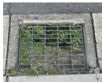
水はけの悪い側溝
