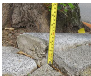
歩道の植樹帯3cmずれ
