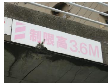
トンネルの天井の傷
