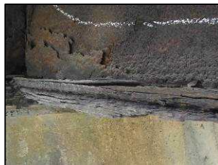
主桁の腐食膨張
