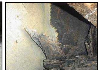
主桁の断面欠損
