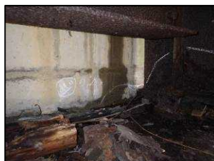
橋座の漏水状況
